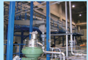
天然ゴム精製装置
