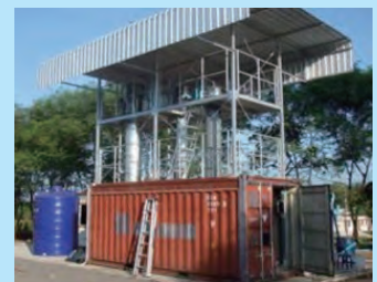
ゴム製造廃水処理装置
