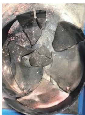
破損したオイル受部
