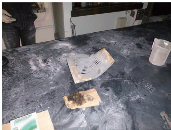
【熱で溶けた天井スピーカーのプラスチックカバー】
