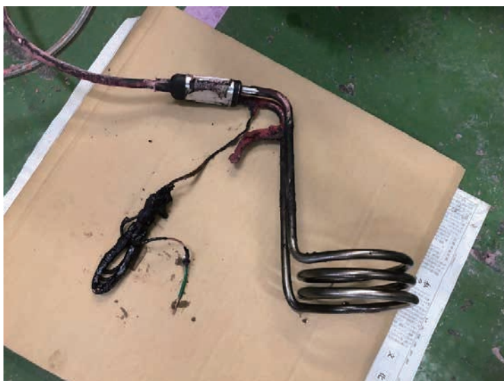
油の入った容器内に設置されていた電気ヒーター
