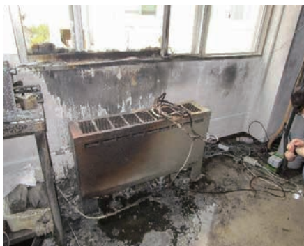
出火場所（軽量作業台撤去後）
