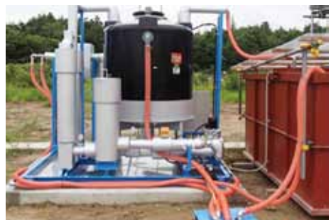
福島県富岡町での除染浄化装置
