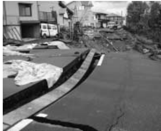
陥没道路と壊滅的ダメージを受けた消雪パイプ。仮にポンプ施設 散水部が健全でも 道路に亀裂があったり勾配が狂っていれば消雪施設としては機能しない。
