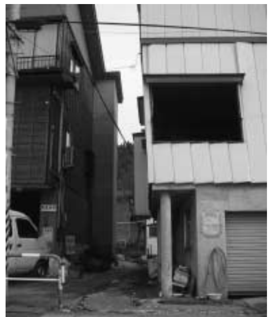
地震によって傾いた家屋。平年値で2mの積雪がある地域であり積雪荷重によって倒壊する危険性が高い。万一倒れれば隣家へ寄りかかり二次災害を引き起こすことになる。
