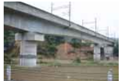
中越地震で被災した上越新幹線の橋梁
