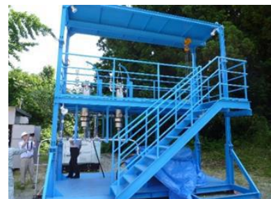
図1 飛灰安定化装置
