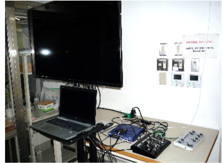
VPNサーバとコントロールパネル
