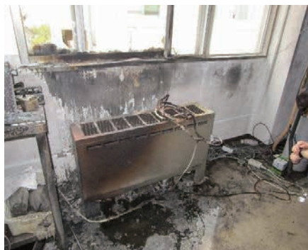
出火場所（軽量作業台撤去後）
