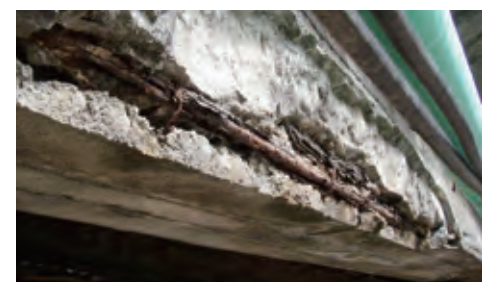
老朽化によって鋼材の腐食が生じた橋(2009年にこの橋の破壊実験を行った)
