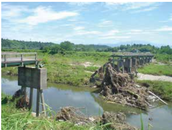
写真1 平成16年7月の水害による刈谷田川橋梁の被災
