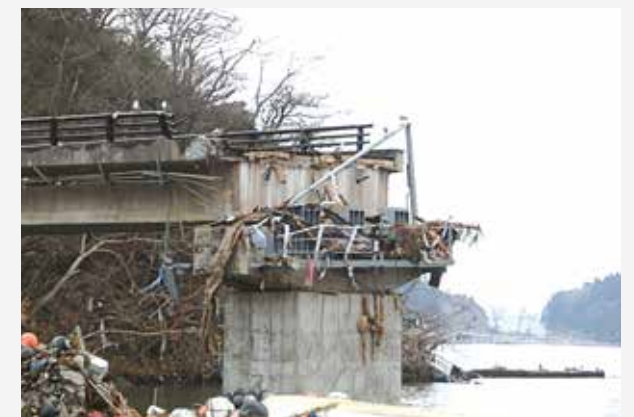
津波による道路橋の流出
