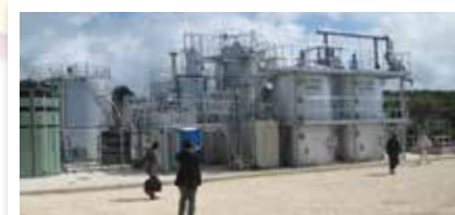
国立環境研究所、長岡工業高等専門学校、企業等と協力してバイオエタノール製造施設の水再生システムを完成(沖縄にて)
