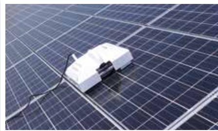
「太陽電池パネル点検ロボットの1号機」 パネル面を自動走行しながら不導通検査を行うロボットは世界初
