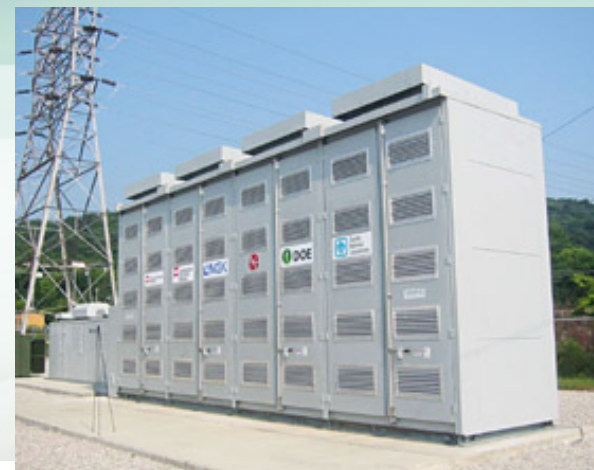
1MW級のシステムのNAS電池
