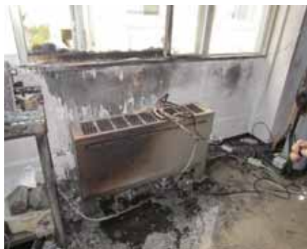
出火場所（軽量作業台撤去後）
