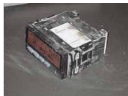
一部が焼けた電圧表示
