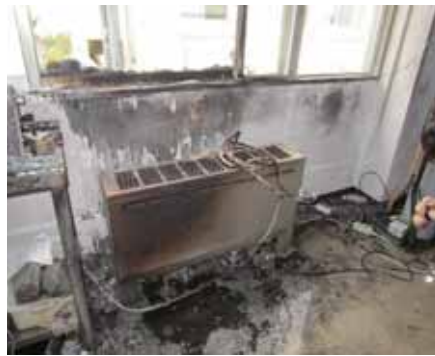
出火場所（軽量作業台撤去後）
