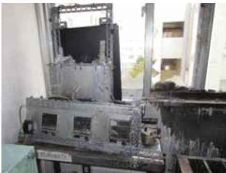
火災発生時に稼働していた 小型電気炉
