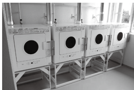
コインランドリー/Laundry Room
